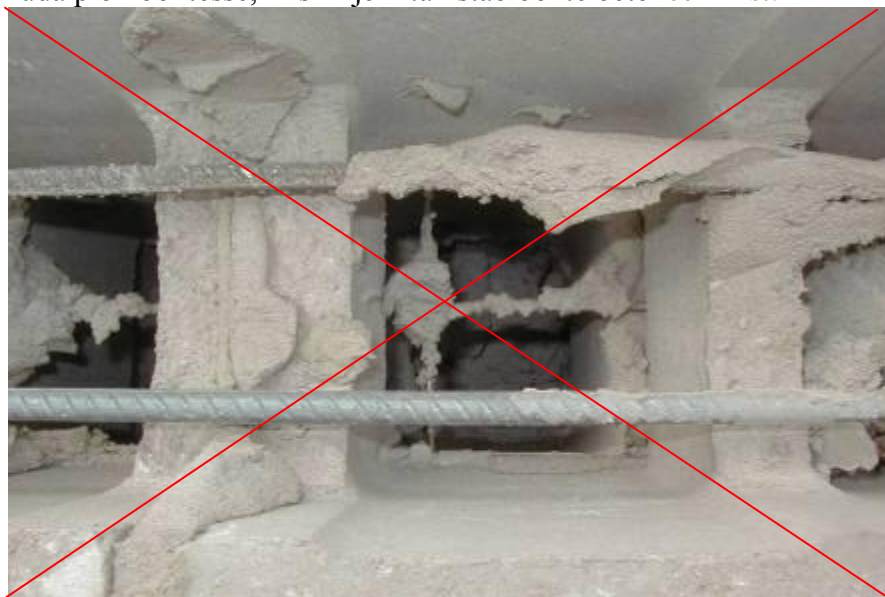
Foto 2 Lubamatult laotud müür (mört on varisenud betoneeritavasse alasse)
